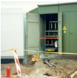
Bild: Schwerer Störlichtbogenunfall durch Missachtung der fünf Sicherheitsregeln
