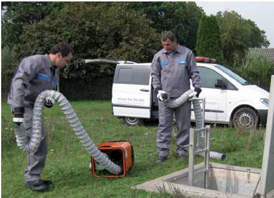
Die mobile Absaugvorrichtung sorgt für eine gefahrlose Schachtatmosphäre.
