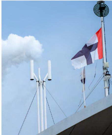
Über den acht Meter hohen Ventilationsmast wird überschüssiges Gas abgelassen.
