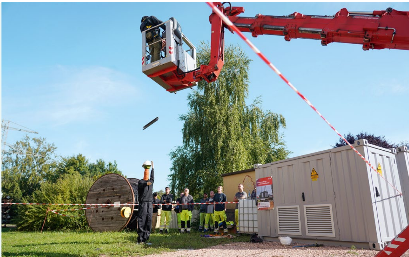
Gefahr von oben: Diese Station zeigt, wie wichtig es ist, beim Arbeiten in der Höhe Gegenstände so zu sichern, dass sie nicht herabfallen können.
