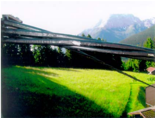
Bild: beschädigte Isolierung des Leiterseil
