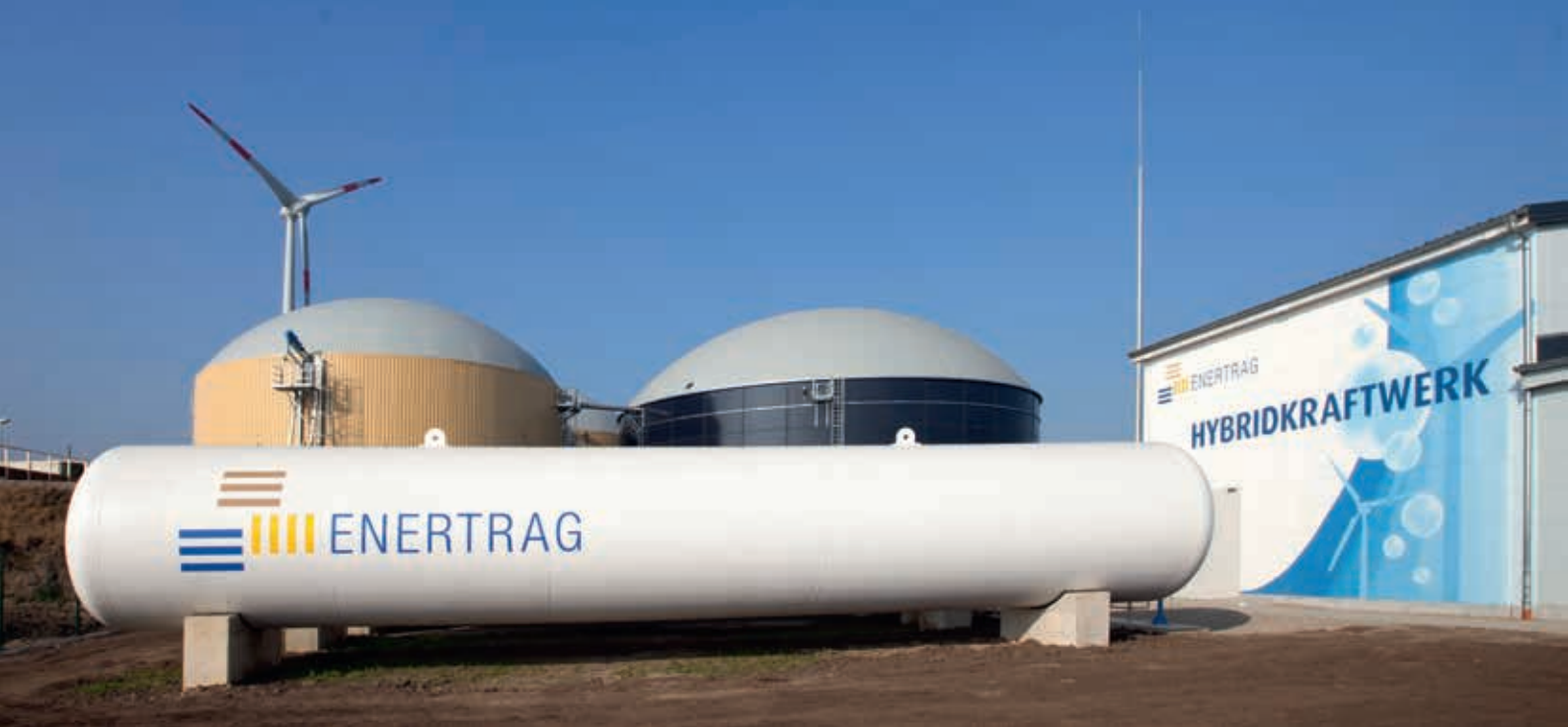
Hybridkraftwerk, in dem mithilfe von Strom Wasser in gasförmigen Wasserstoff und Sauerstoff zerlegt wird.
