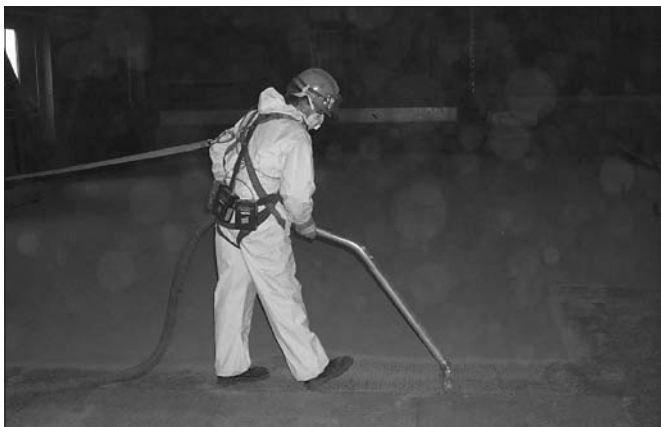
Bild 5. Reinigungstätigkeit im Müllbunker mit Staubsauger.
