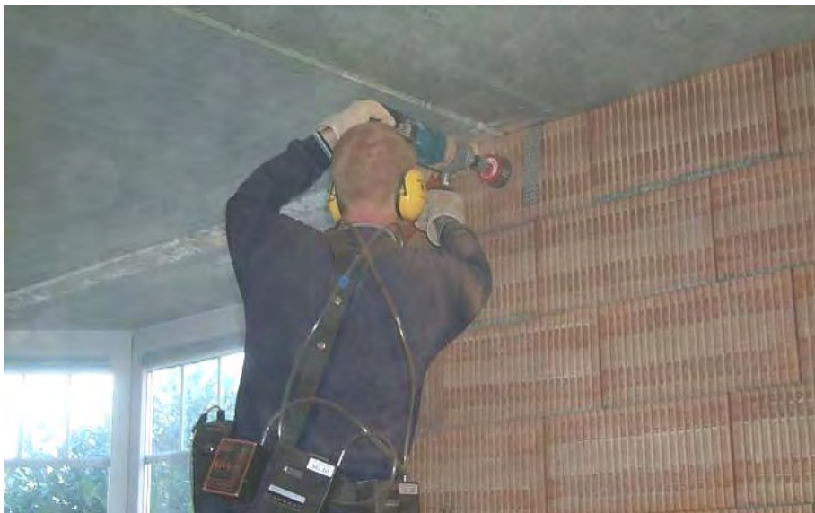
Bild 10: Dosensenken ohne Absaugung in einem Rohbau
