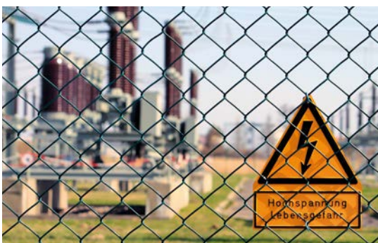
Arbeiten in elektrischen Anlagen
