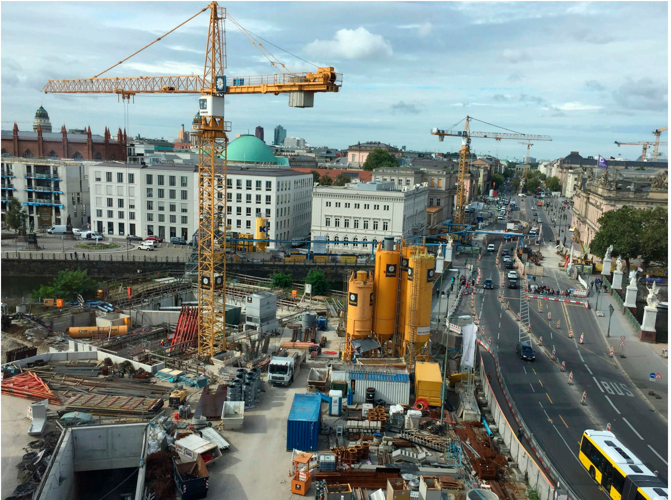
Elektrische Anlagen und Betriebsmittel auf Baustellen müssen besonders geschützt sein.
