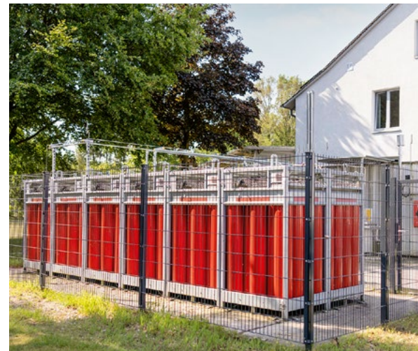
Die roten Druckgasflaschen neben dem Bürogebäude speichern den Wasserstoff.
